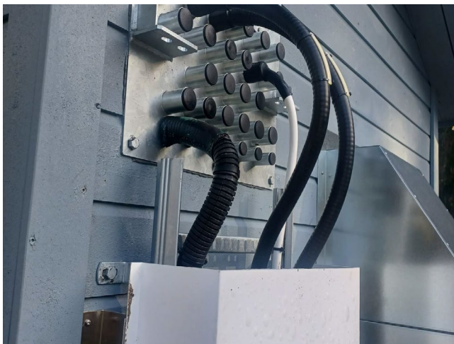
Elektro installasjon og Griptel inntaksplate
